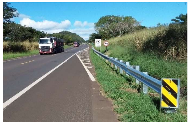
Figura 7: Exemplo de terminal absorvedor de energia (TAE)
